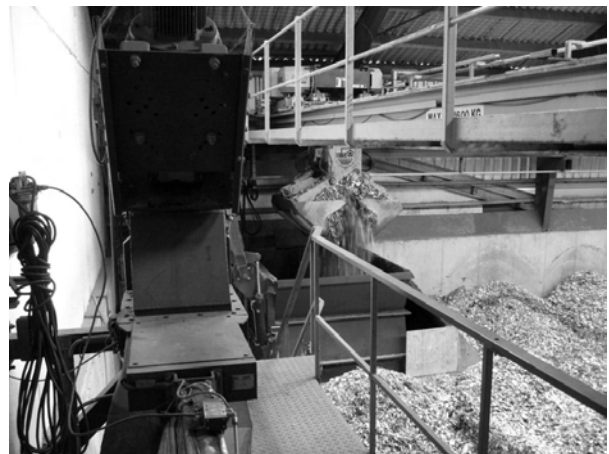
写真5 原料ピットおよびガス化炉への供給系
