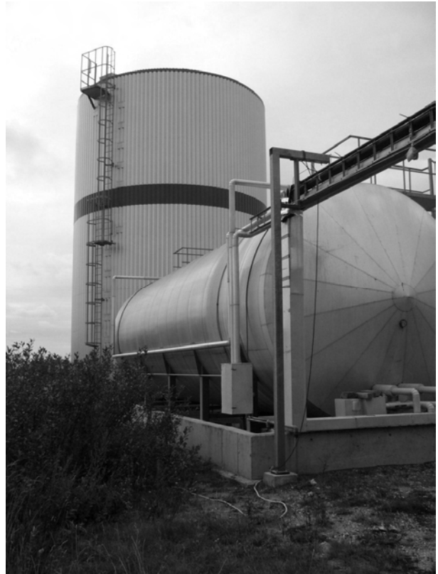
写真4 タールタンクおよび温水タンク
